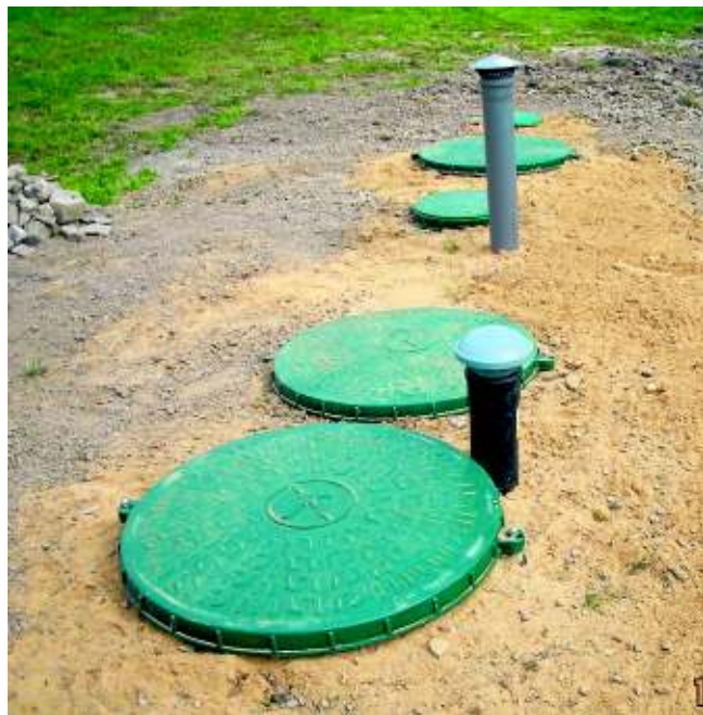
Gmina oddała do użytku 800 przydomowych oczyszczalni ścieków
